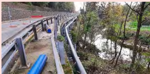
Condotta staffata su ponte S.P. 135
