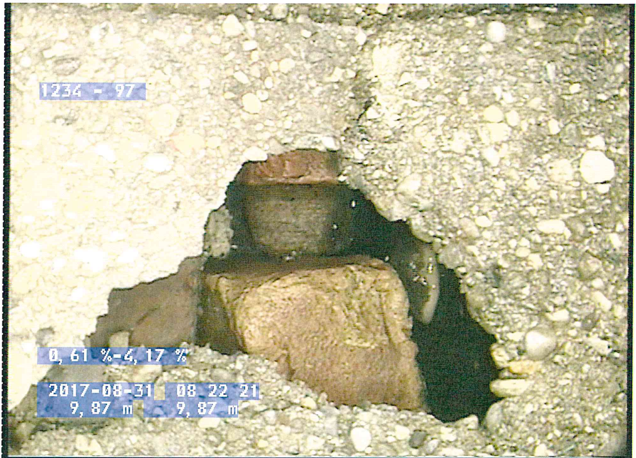
Foto 2 – Tratto iniziale della condotta, dettaglio del cedimento della parete, cunicolo esterno a vista, malta mancante, mattoni sconnessi, forte infiltrazione di liquami.
