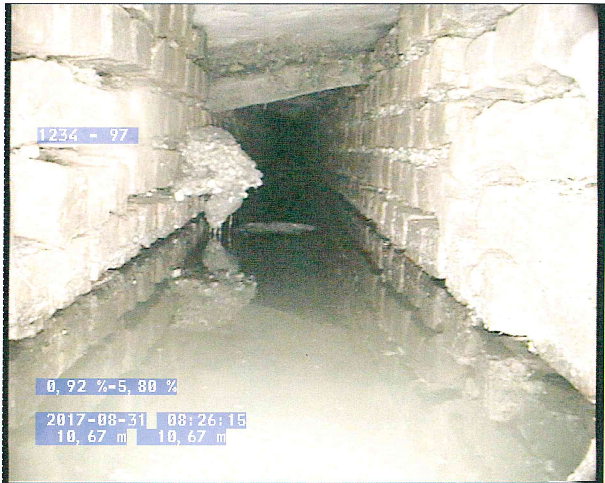
Foto 5 - Assenza della condotta per cedimento, assenza di fondo di scorrimento, numerosi detriti sul fondo, mattoni disallineati e mancanti, evidente cedimento all'apice.
