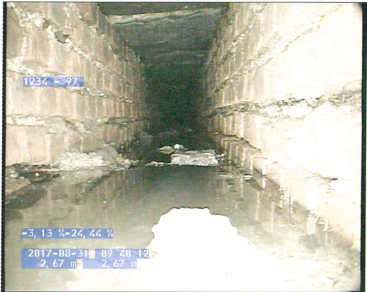
Foto 4 - Assenza della condotta per cedimento, assenza di fondo di scorrimento, numerosi detriti sul fondo, mattoni disallineati e mancanti
