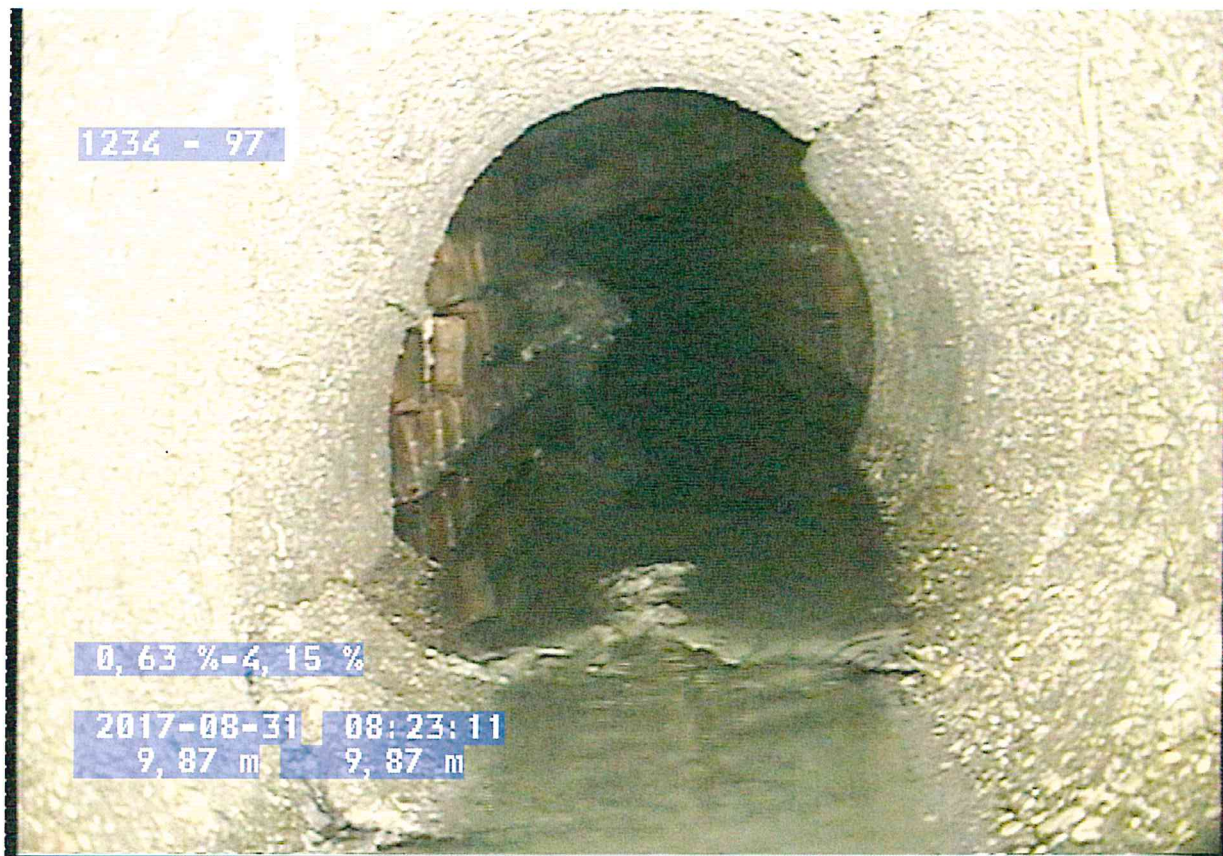
Foto 3 – Cedimento totale della condotta, videoispezione interrotta per assenza del fondo, cunicolo visibilmente danneggiato, assenza di malta tra i mattoni, mattoni sconnessi, apice ceduto parzialmente
