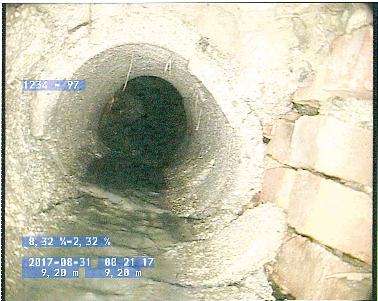
Foto 1 – Tratto iniziale della condotta, marcatamente ovalizzata, cedimento all'apice, cedimento fondo, crepe profonde lungo le pareti laterali, giunti sconnessi, tratti ceduti con cunicolo esterno a vista, malta tra i mattoni mancante, fondo mancante.
